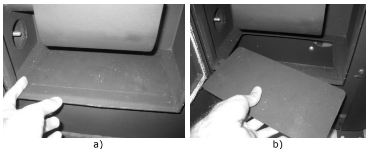
Figura 140 – Limpeza do interior da salamandra
